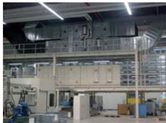
Effektive Abwärmenutzung bei Hettich in Kirchlengern: Die Abwärme wird aus der aus der Druckluftherzeugung und den Einbau eines Druckluftmanagements realisiert.
